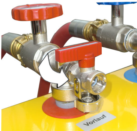
Bild: Kugelhahn der Entlüftungsleitung öffnen
